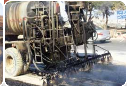
صهاريج اسفلت وقود (٥) Asphalt/ Petrol Tanks (5)
