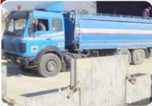
صهاريج ماء (٥) Water Tank (5)
